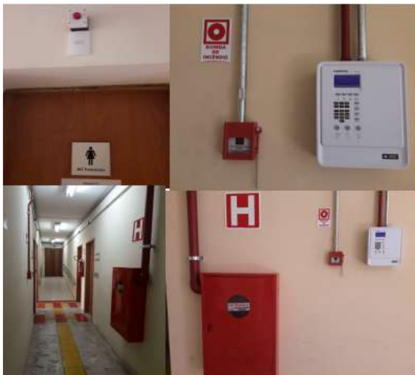
Figura 22. Elementos de Green and Smart Buildings do campus Inconfidentes: Sensor de presença e sistemas de incêndio
