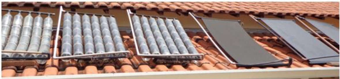
Figura 18: Módulos instalados. Fonte: Elaboração própria
