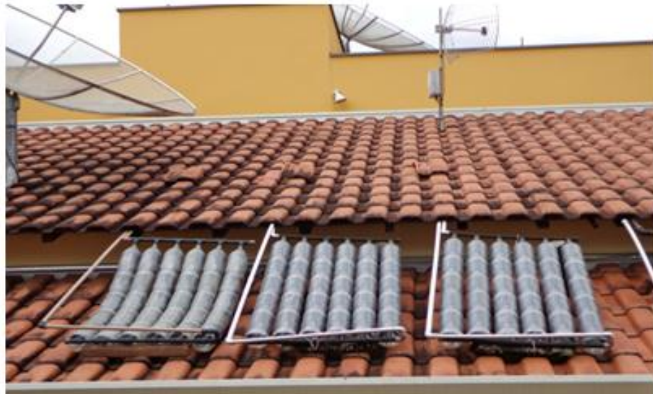
Figura 17: Aquecedor solar de PET e caixa de leite instalado Fonte: Elaboração própria
