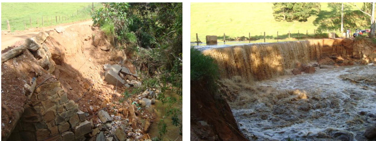
Figura 10 : Pessimas condições das vias de acesso do Bairro Vargem Grande. (Foto: Arquivo pessoal).
