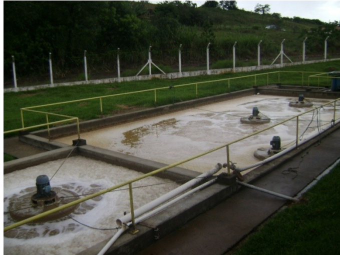
Figura 2. Tanque de sedimentação da indústria de bebidas.
