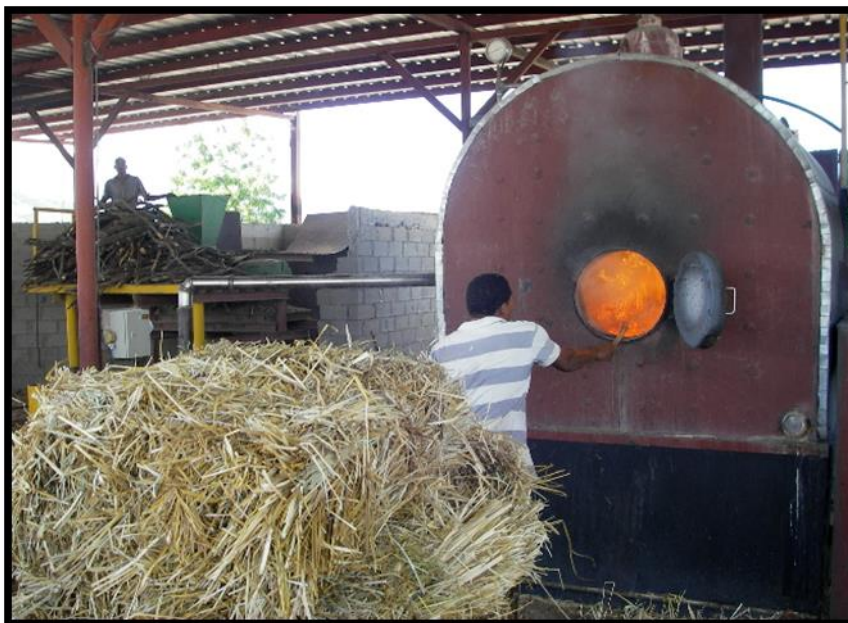
Figura 15. Vetiver usado como biocombustível para abastecer caldeira (Fonte: TVNI, 2013).
