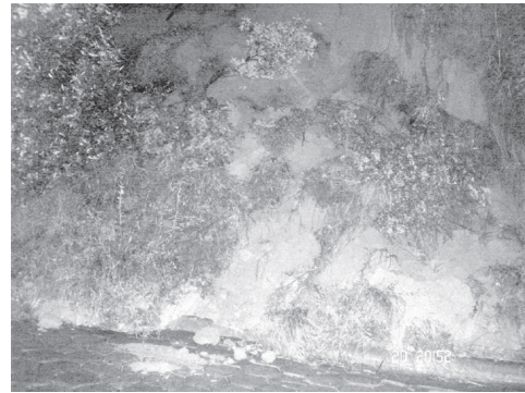
Figura 31 – Deslizamento na Rua Manoel Jesuíno de Carvalho (Fonte: Gazeta de Ouro Fino, Nov. 2006).
