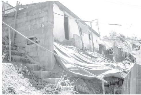
Figura 35 - Casa destruída pelas chuvas (Fonte: Gazeta de Ouro Fino, Jan. 2007).
