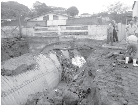
Figura 51 - Parte da ponte que caiu (Fonte: Gazeta de Ouro Fino, Set. 2009).
