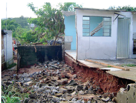
Figura 18 – Casa atingida pelas chuvas (Fonte: Gazeta de Ouro Fino, Fev. 2006).
