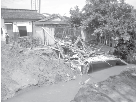
Figura 49 - Muro da casa levado pela chuva (Fonte: Gazeta de Ouro Fino, Set. 2009).
