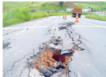
Figura 34 - Trecho da Rodovia MG 290, Km 53 que afundou devido ao excesso das chuvas (Fonte: Gazeta de Ouro Fino, Jan. 2007).
