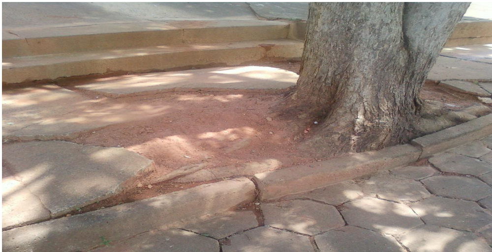
Figura 5: Calçamento danificado da Praça Edson Chiste Bailon.
