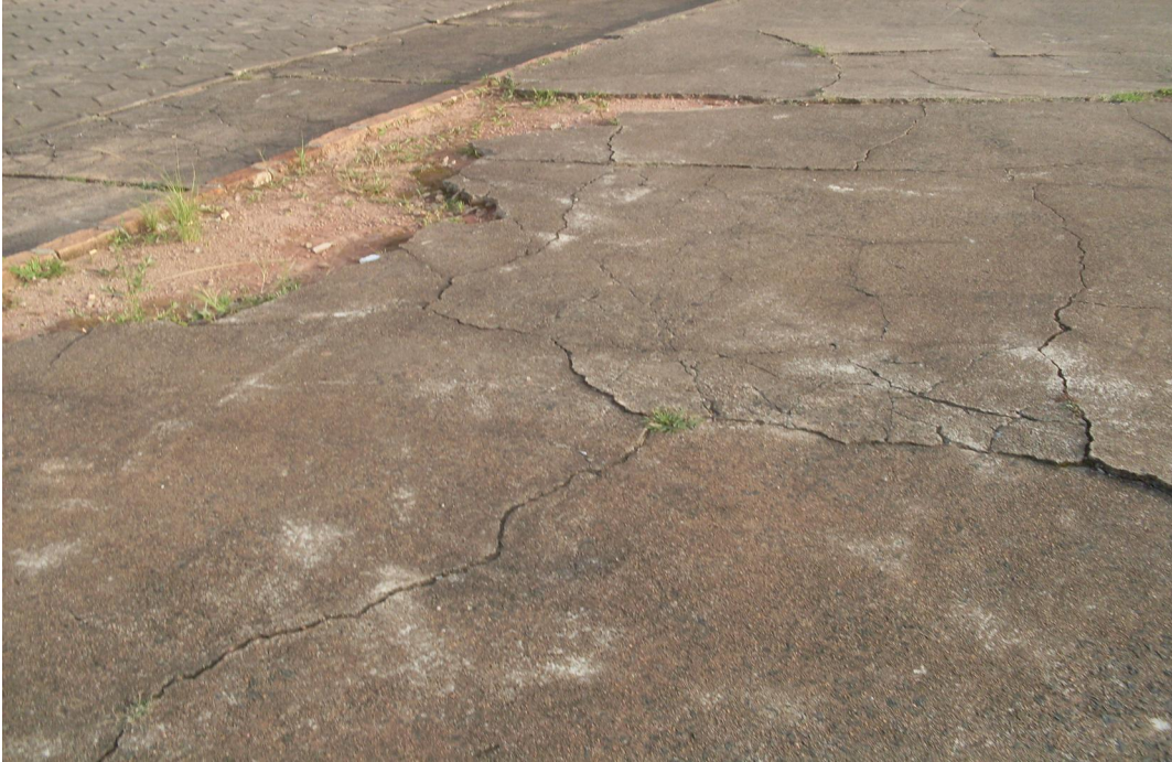
Figura 6: Calçamento da Praça Edson Chiste Bailon com rachaduras, trincas e placas de cimento soltas.
