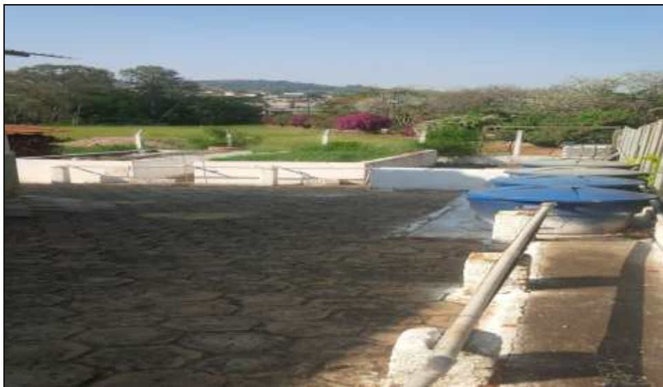
Figura 5: Sistema de Tratamento de Resíduos Líquidos de laticínios. IFSULDEMINAS – Câmpus Inconfidentes. Fonte: elaboração própria.
