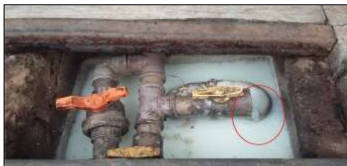
Figura 13: Caixa de gordura laticínio do IFSULDEMINAS – Câmpus inconfidentes. Fonte: elaboração própria.
