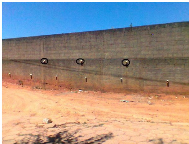
Figura 8- Muro frontal do cemitério, local o qual o escoamento superficial do interior do cemitério é lançado na rua.
