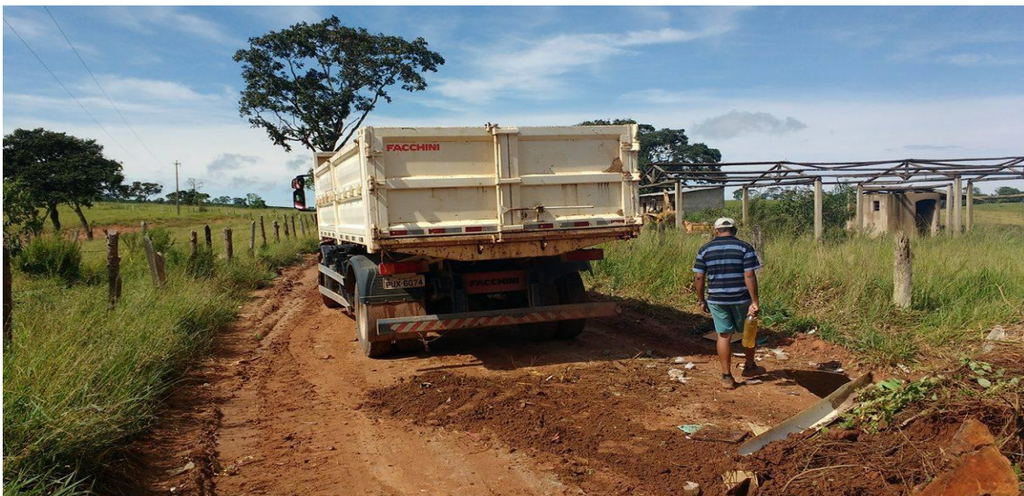
Figura 15: Caminhão basculante utilizado para transporte de solo no aterro/ Fonte: Próprio Autor.
