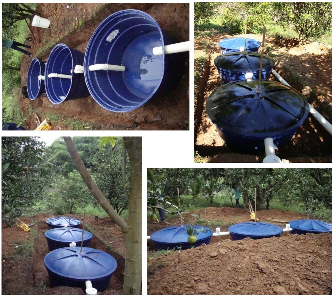
Figura 11: Sistema de esgoto sanitário implantado. Fonte: Arquivo pessoal, 2014.
