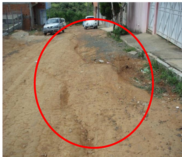
Figura 7 B- Erosão na rua.
