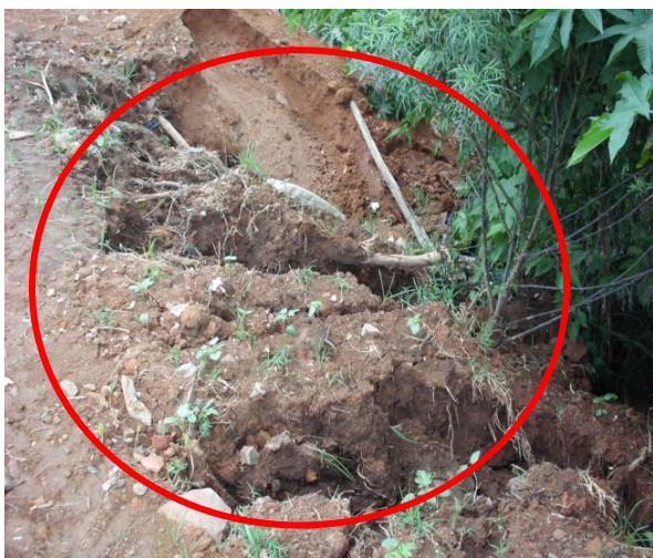
Figura 7 A- Erosão na beira da rua.
