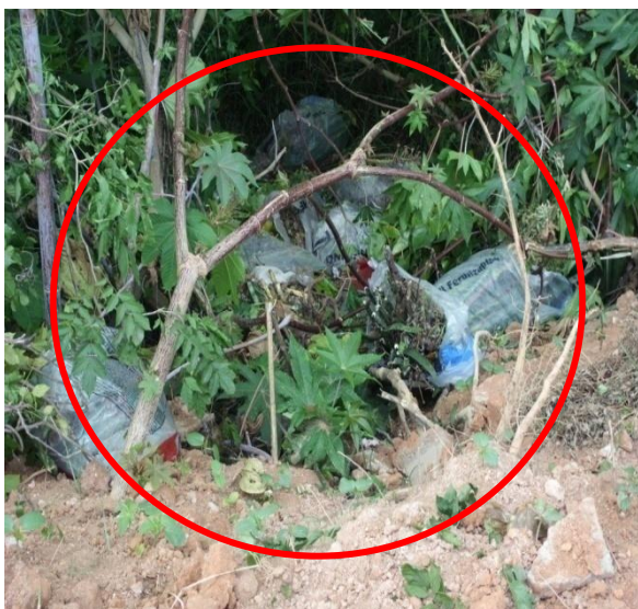
9 C- Lixo na parte que ocorreu erosão.
