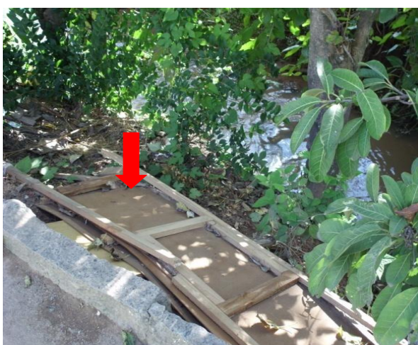
8 C- Entulho na margem do rio
