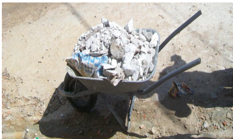
Figura 07: Resíduos de gesso. Fonte: (Arquivo pessoal).
