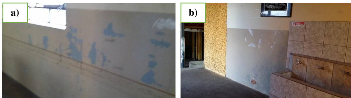
Figura.5. Depredação das paredes
