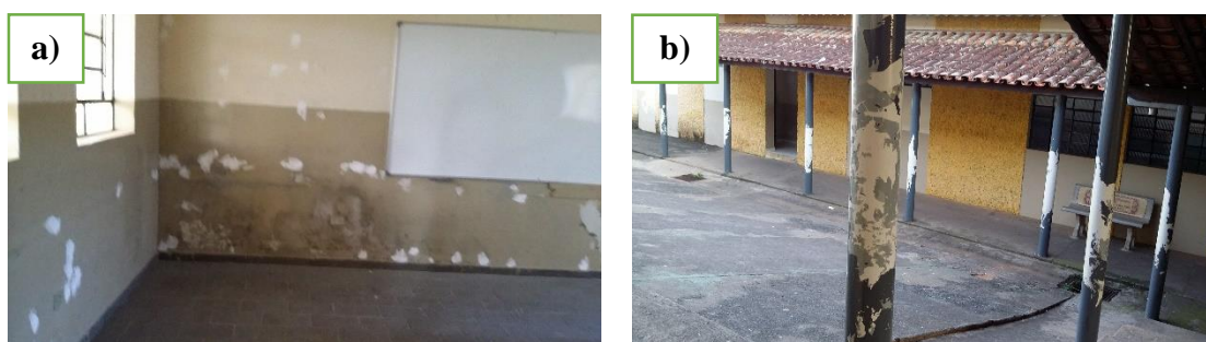
Figura.2. Paredes e colunas danificadas.
