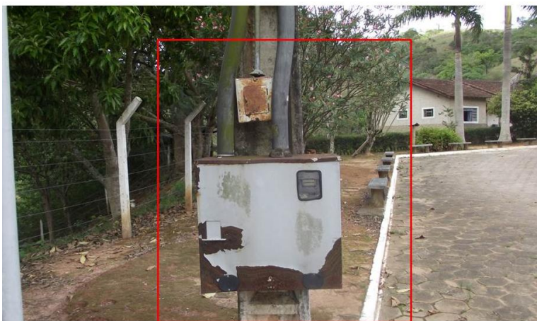
Figura 21. Dispositivo de desligamento emergencial do setor de bovino de leite do IFSULDEMINAS – Câmpus Inconfidentes. Inconfidentes/MG, 2013.
