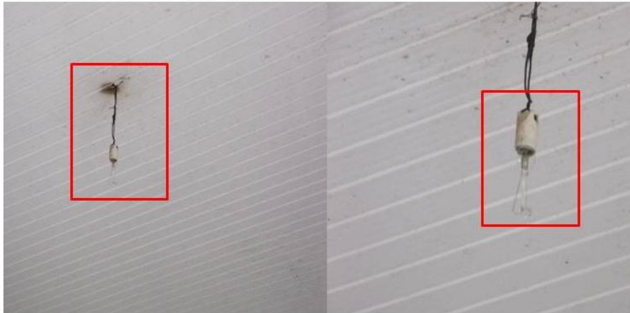
Figura 19. Lâmpada quebrada na sala de armazenamento do leite do setor de bovinocultura leiteira do IFSULDEMINAS – Câmpus Inconfidentes. Inconfidentes/MG, 2013.
