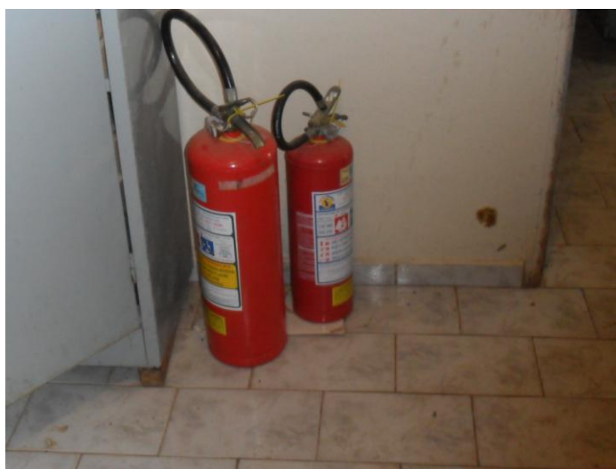
Figura 23. Extintores do escritório bovino de leite do IFSULDEMINAS- Câmpus Inconfidentes. Inconfidentes/MG,2013
