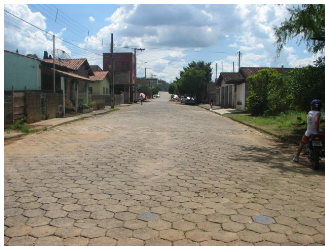
Figura 15- Rua sem bueiros
