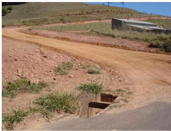
Figura 18- Bueiro em novo loteamento
