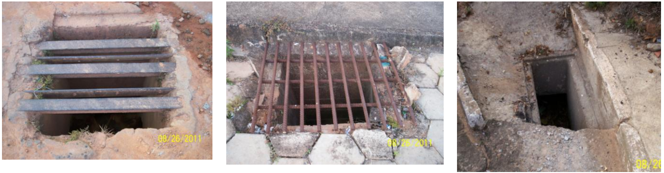
Figura 17- Apesar de serem bueiros novos, vê-se claramente que os mesmos não têm padrão, e o último não possui grades, podendo levar a ocorrência de acidentes.
