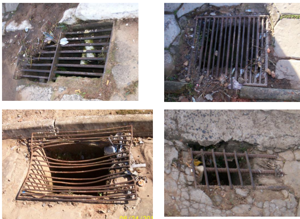
Figura 16- Bueiros em mal estado de conservação
