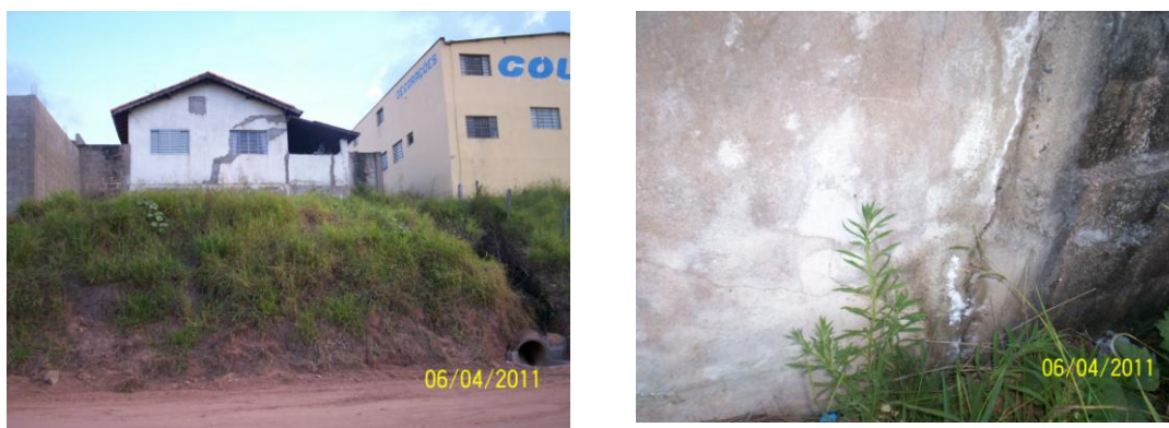
Figura 8 – Danos causados por erosão e locais aterrados para construções
