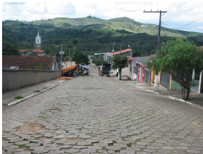
Figura 12 – Estado da pavimentação após o período chuvoso Fonte: Peixoto, L. H. (2009).
