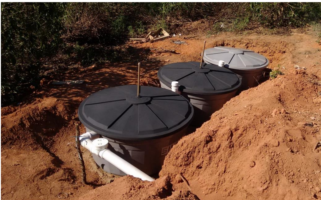
Figura 18: Sistema completo das fossas sépticas biodigestoras.
