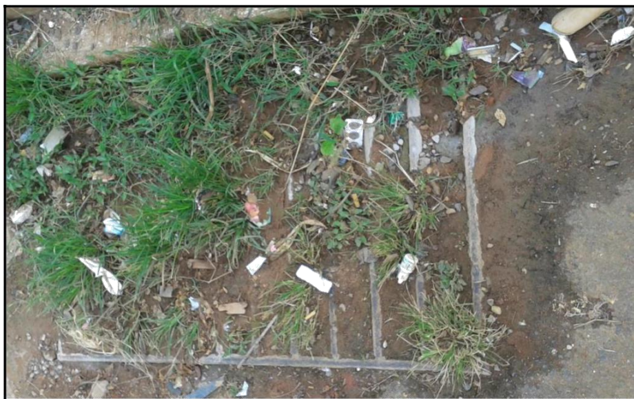
Figura 6: Condições dos bueiros ou “boca de lobo”.
