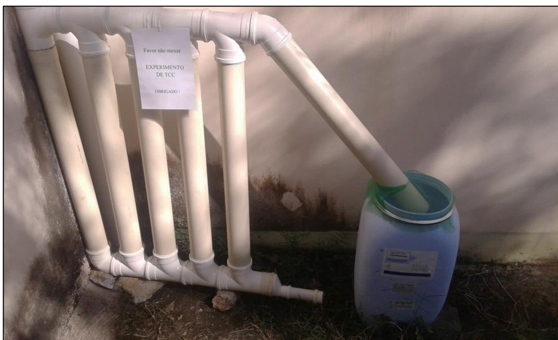
Figura 02. Filtro modelo- DesviUFPE construído- Campus Inconfidentes.
